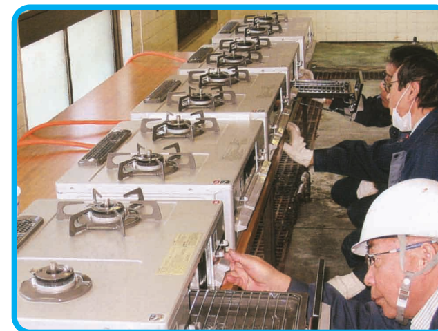
避難所に設置したガスコンロ点検
